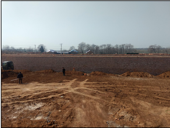
照片 1.3-1 新建隧道窑
